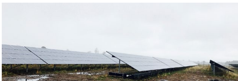
26 avril 2018 : Visite des centrales photovoltaïques d'Électricité du Soleil du Bassin à Caudos (Mios) avec Yves Jacquin Depeyre, Président
